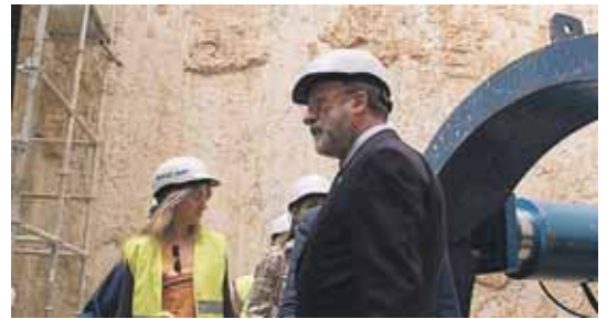
El alcalde de Valladolid, Javier León de la Riva, visitó las obras del colector
