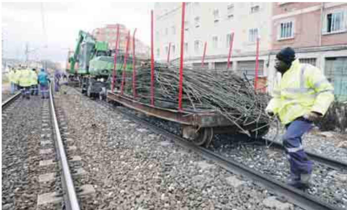
Los trabajos de desmantelamiento del antiguo trazado ferroviario comenzaron el mismo día 15.
