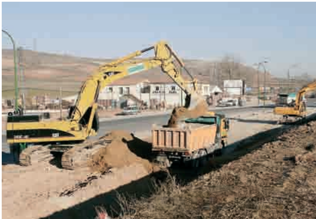
Las obras del vial de la calle Francisco Salinas han comenzado a buen ritmo en uno de sus laterales.
