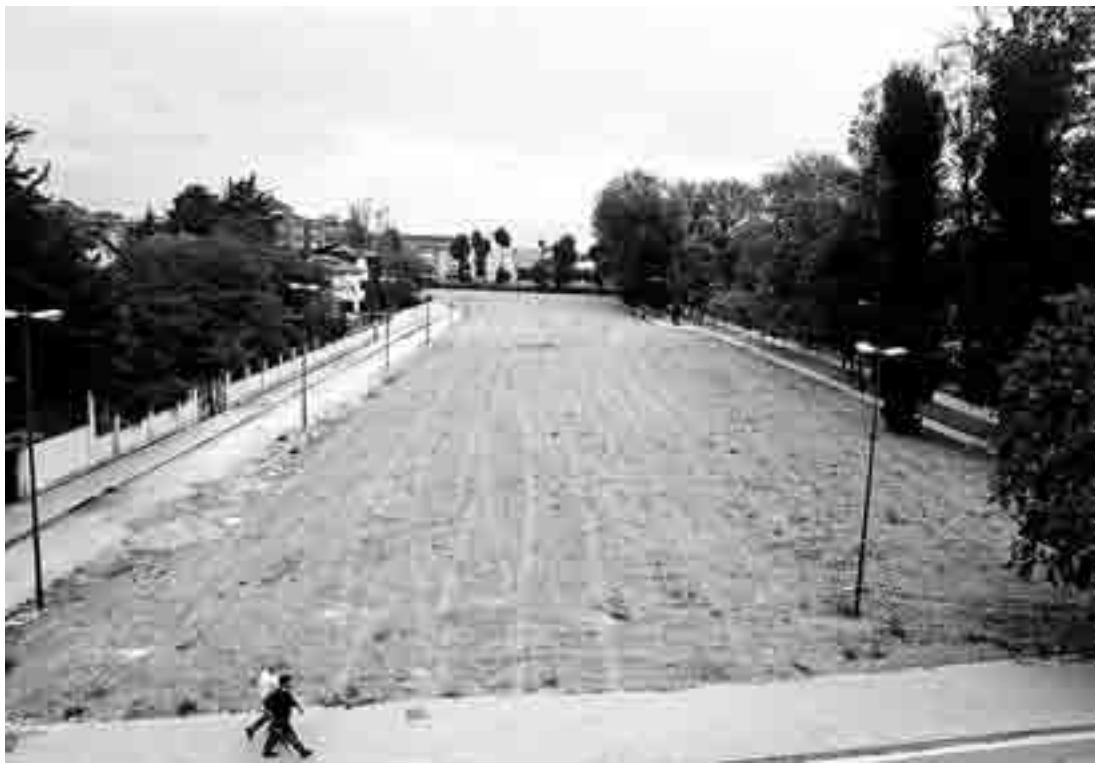
Las obras en el parque de La Quinta finalizarán a lo largo del primer trimestre de 2007.
