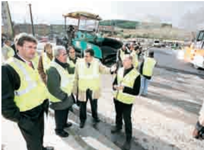
El alcalde visita las obras de construcción del túnel de Islas Baleares.
