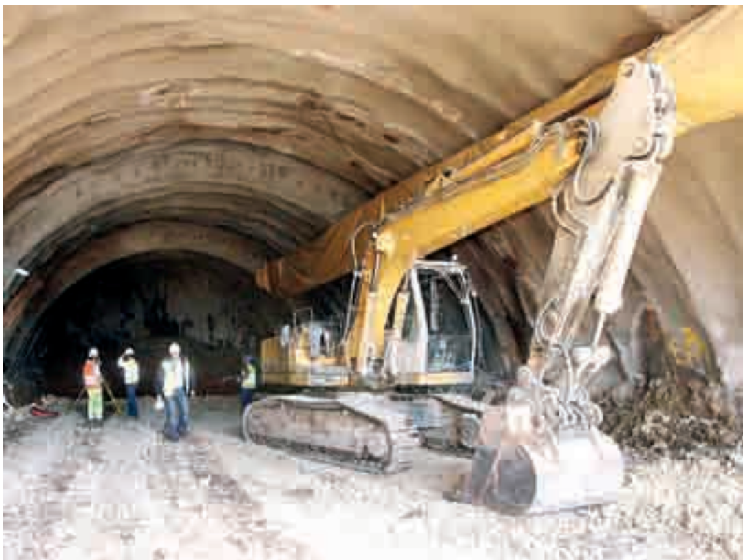
Los trabajos de construcción del subterráneo se realizan a tres turnos, con un avance de cinco metros al día.
