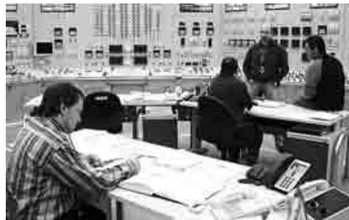
Sala de control de la central de Garoña, que da trabajo a 600 personas.
