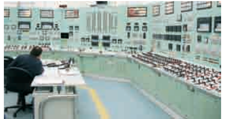
La central de Garoña generó en 2006 3.842 millones de kWh, el equivalente al 31,25% del consumo eléctrico de Castilla y León. En la imagen, sala de control.
