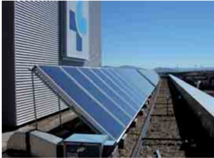
Paneles solares en la cubierta de un centro hospitalario.
