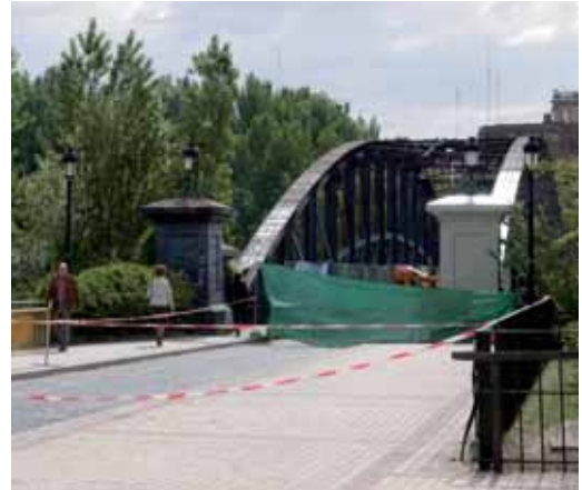
El Puente Colgate se encuentra cortado al tráfico.
