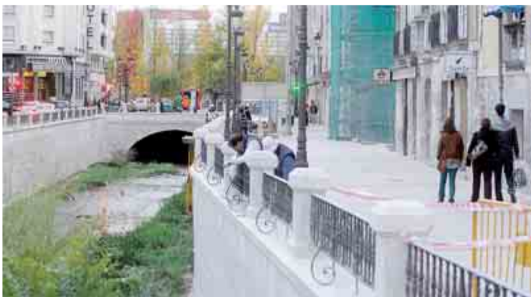
Continúa la obra de rehabilitación de la estructura de encauzamiento del río Vena en la calle Gran Teatro.
