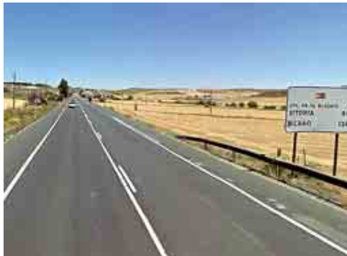
El estado de conservación de la N-1 presenta deficiencias.
