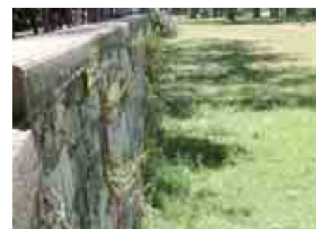
La vegetación ha 'saltado' de la ribera del río Arlanzón al muro de encauzamiento.
