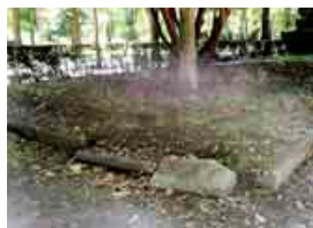
La pérdida y desencaje de bordillos es más que evidente, están rotos, hundidos...s
