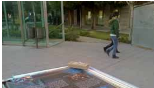
Marquesina de la calle Santiago a punto de ser reparada.
