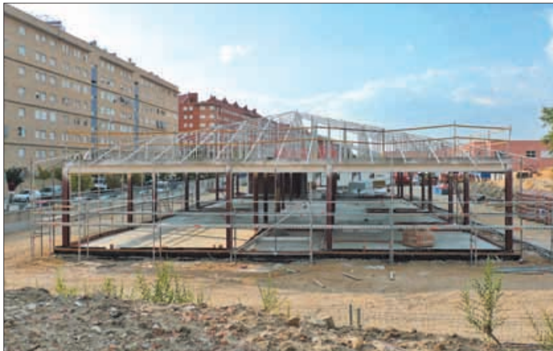
Los vecinos aseguran que el nuevo edificio estaba prometido para el inicio del curso 2010-2011
