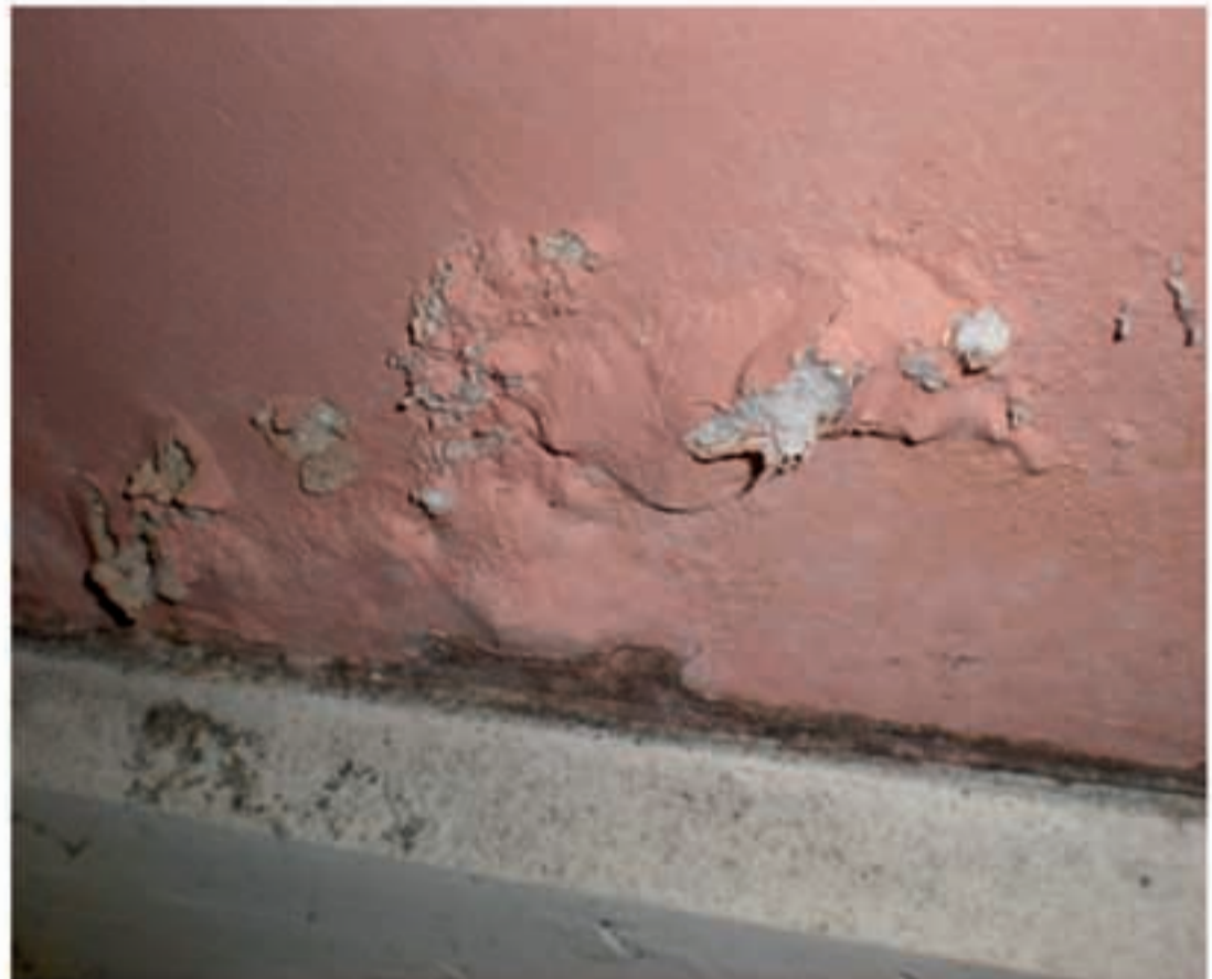
Problemas de humedad en una vivienda.
