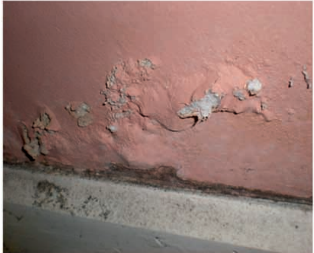
Problemas de humedad en una vivienda.
