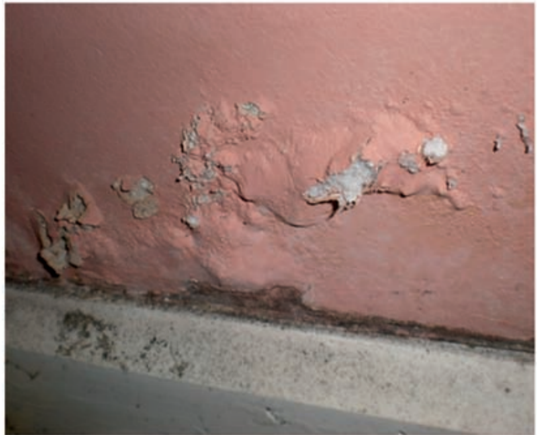
Problemas de humedad en una vivienda.
