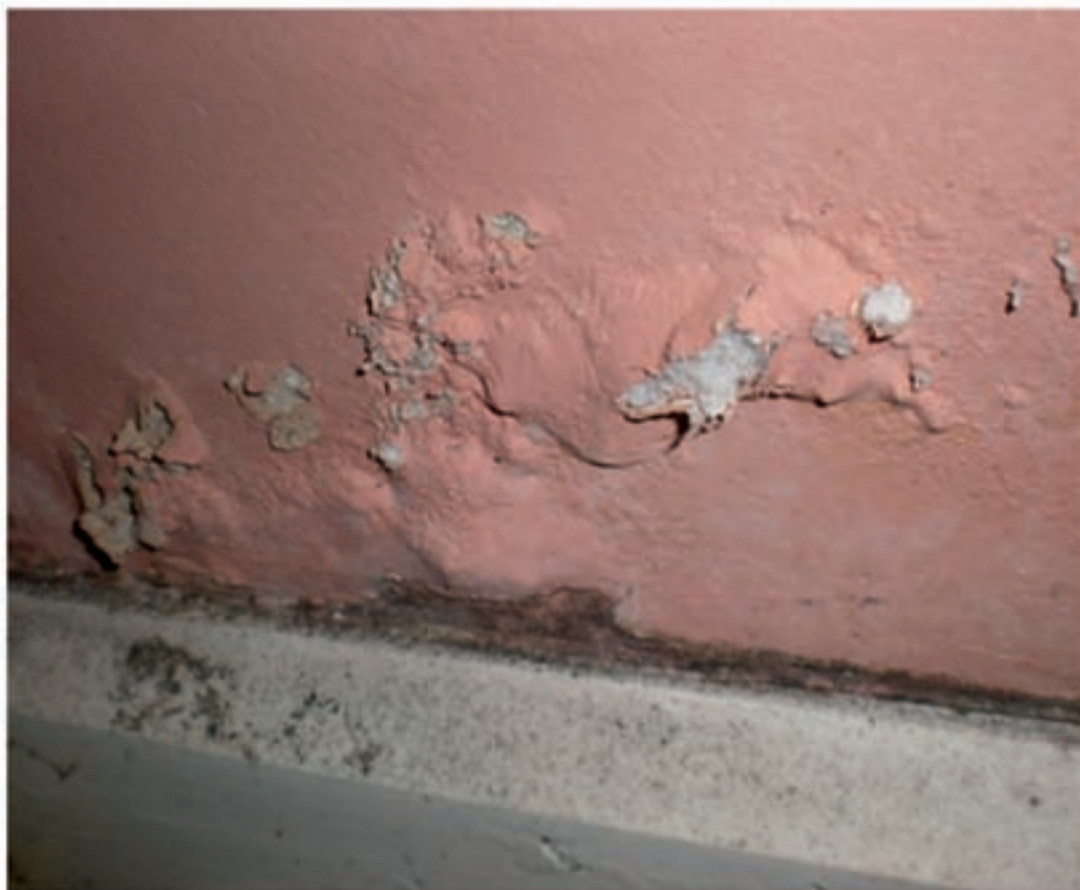
Problemas de humedad en una vivienda.
