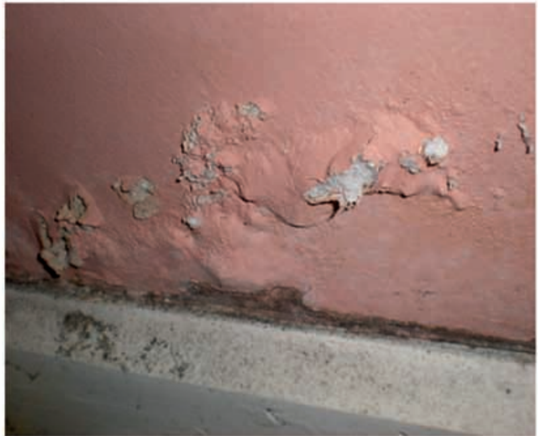
Problemas de humedad en una vivienda.
