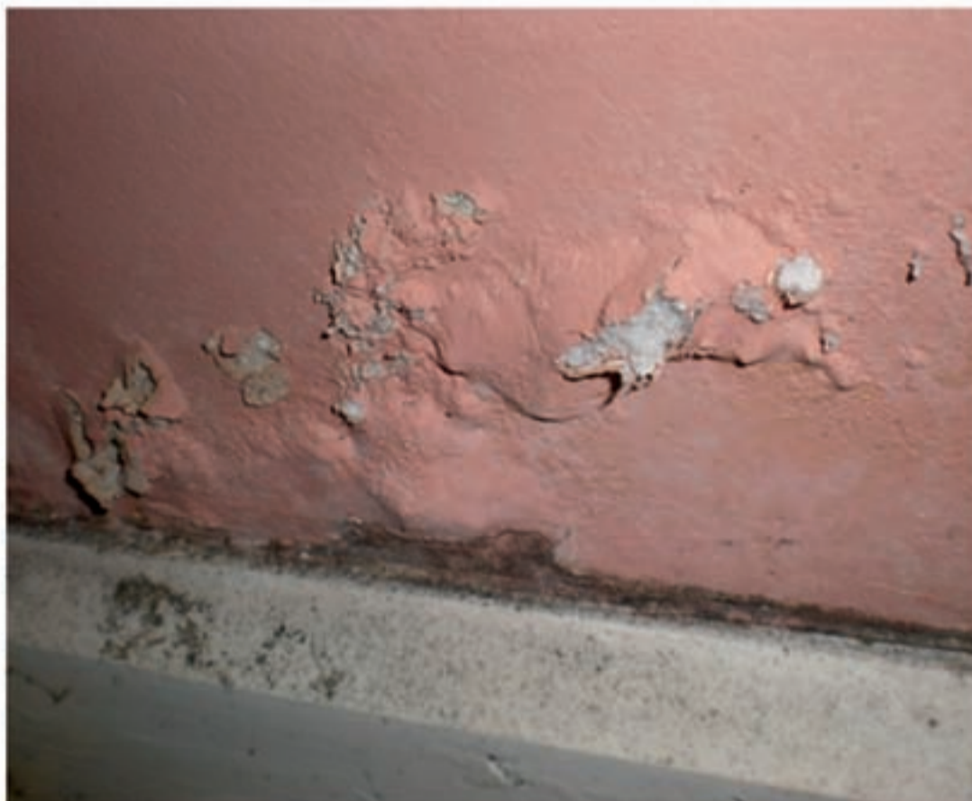
Problemas de humedad en una vivienda.
