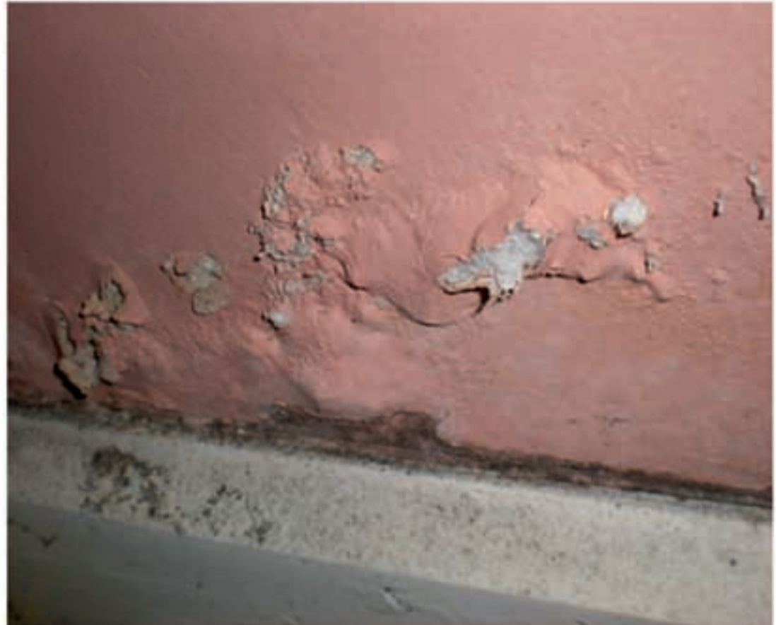
Problemas de humedad en una vivienda.
