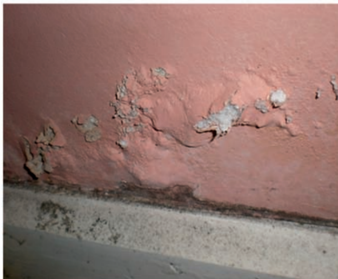
Problemas de humedad en una vivienda.
