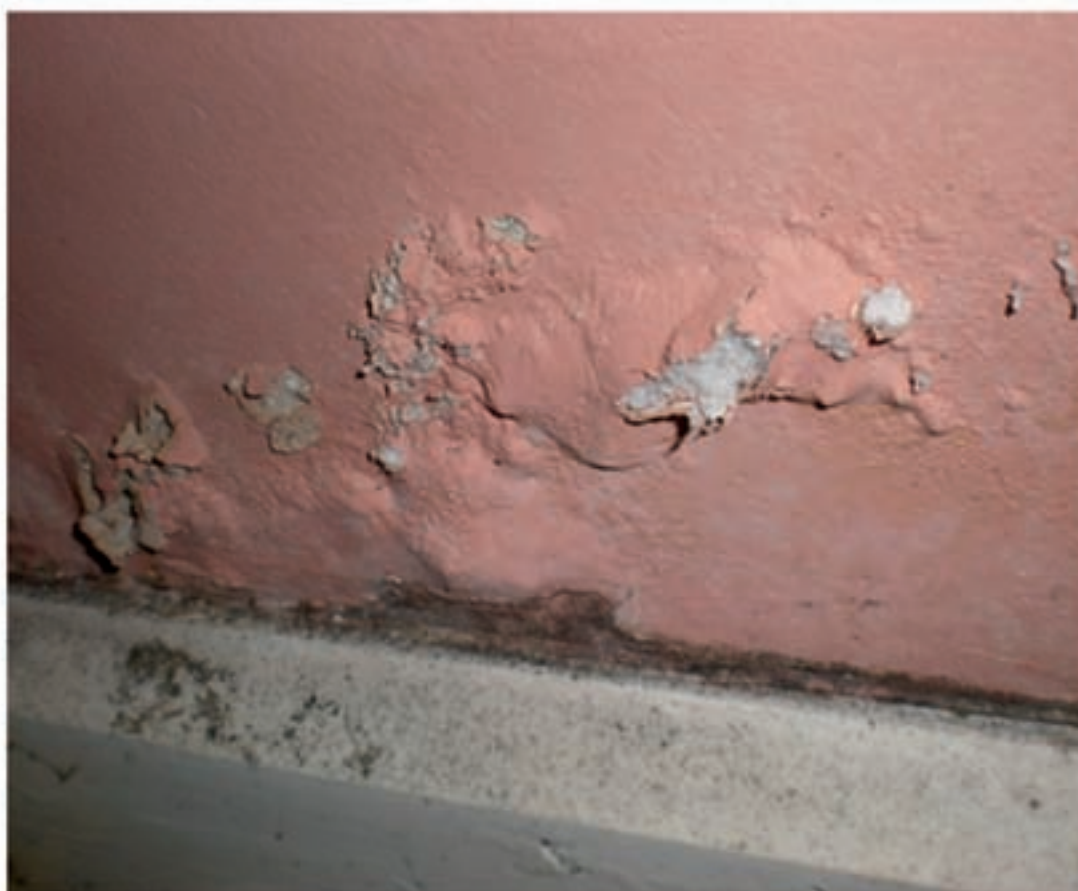
Problemas de humedad en una vivienda.
