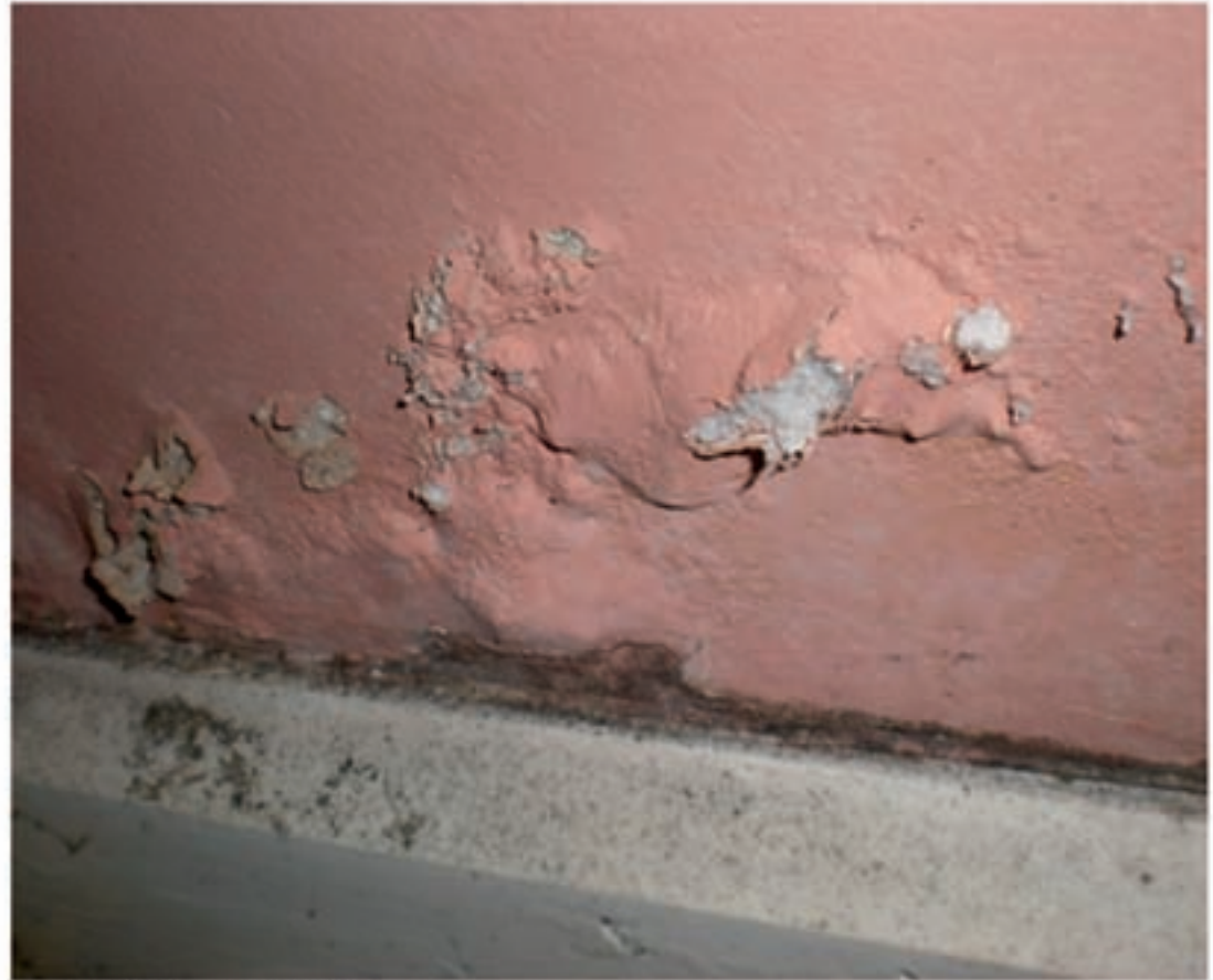
Problemas de humedad en una vivienda.
