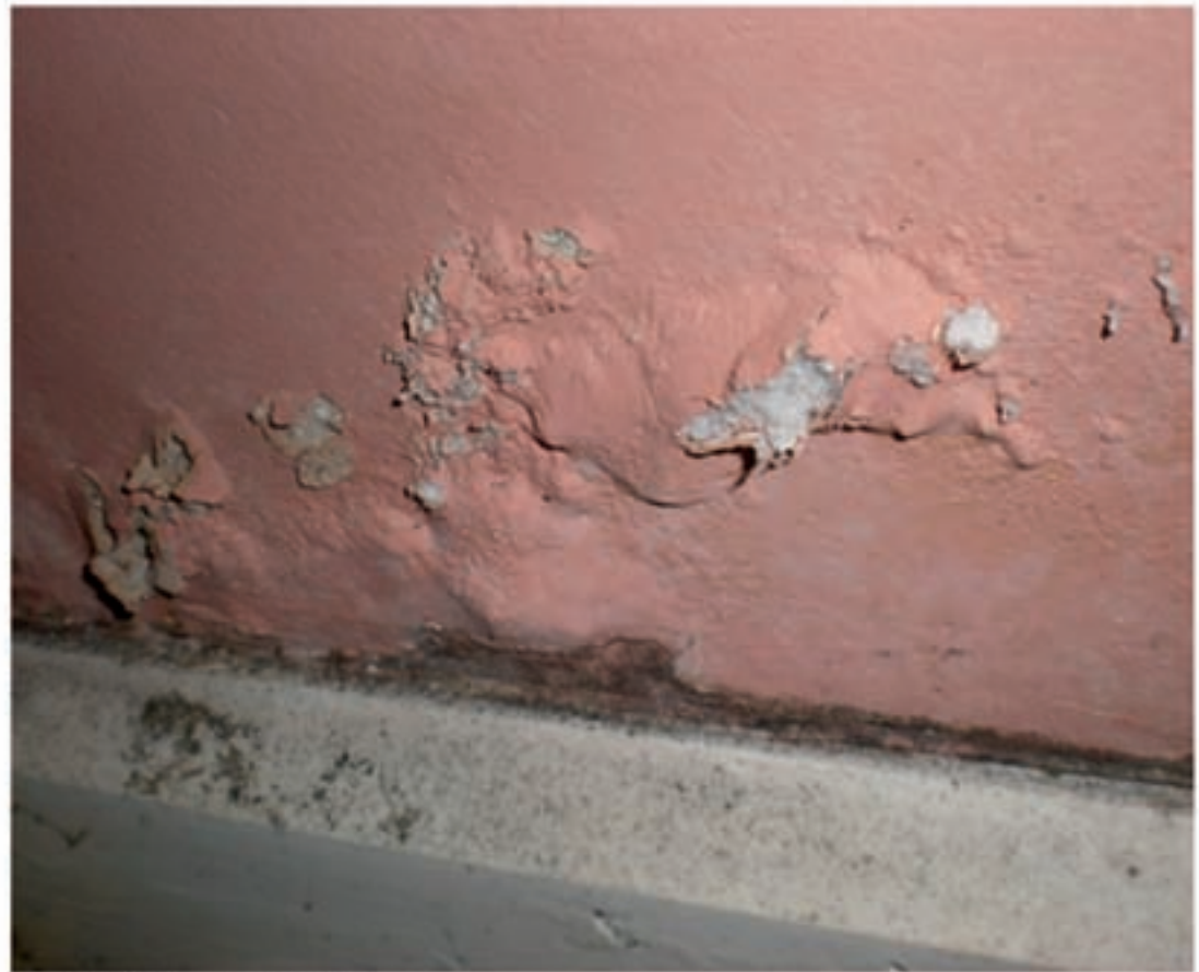
Problemas de humedad en una vivienda.
