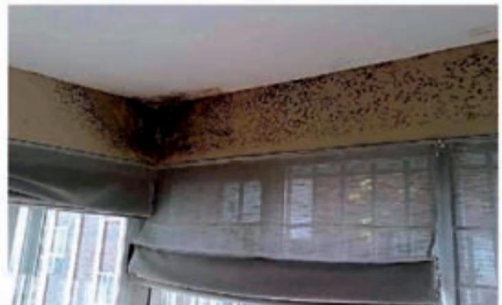
Problemas de humedades por condensación
