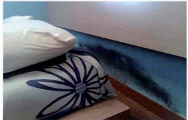
Problemas de humedades por capilaridad
