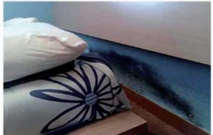
Problemas de humedades por capilaridad
