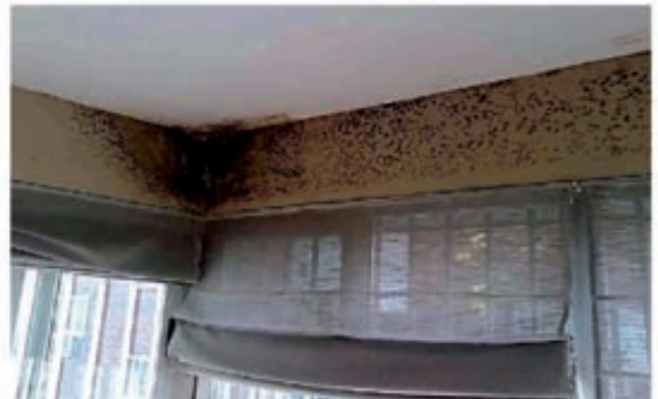
Problemas de humedades por condensación
