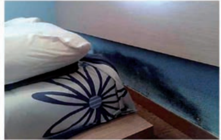
Problemas de humedades por capilaridad
