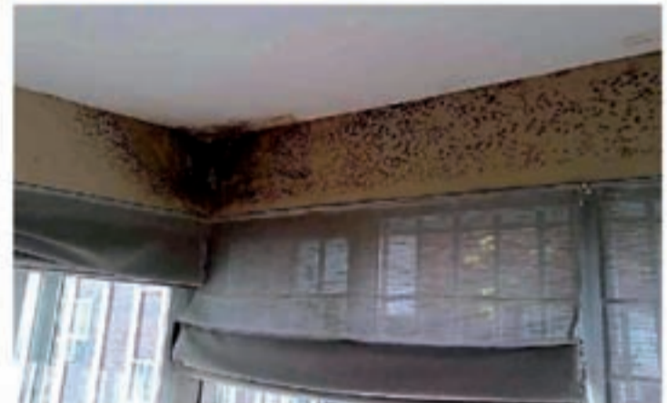
Problemas de humedades por condensación
