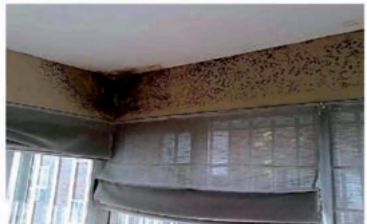
Problemas de humedades por condensación
