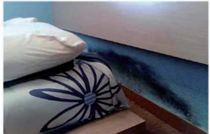
Problemas de humedades por capilaridad
