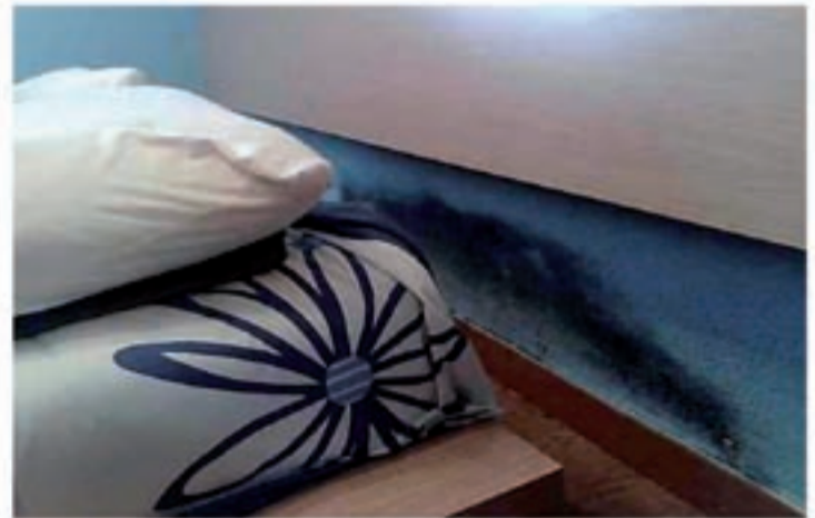
Problemas de humedades por capilaridad
