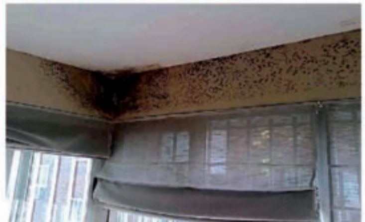
Problemas de humedades por condensación
