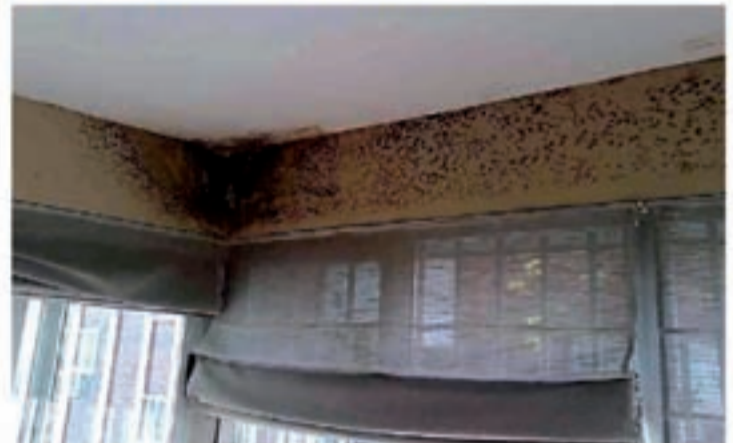
Problemas de humedades por condensación
