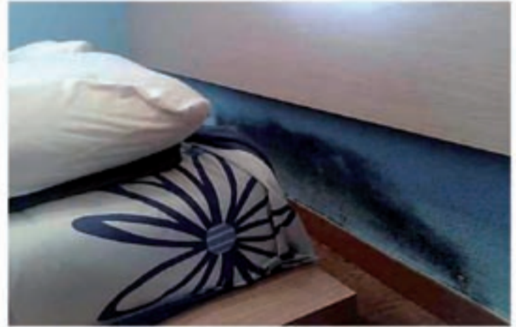
Problemas de humedades por capilaridad
