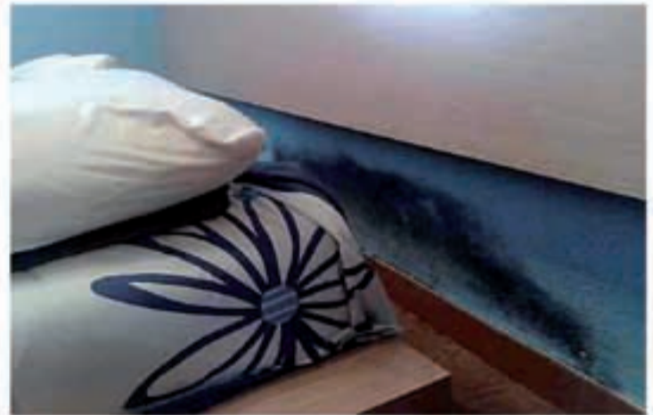
Problemas de humedades por capilaridad
