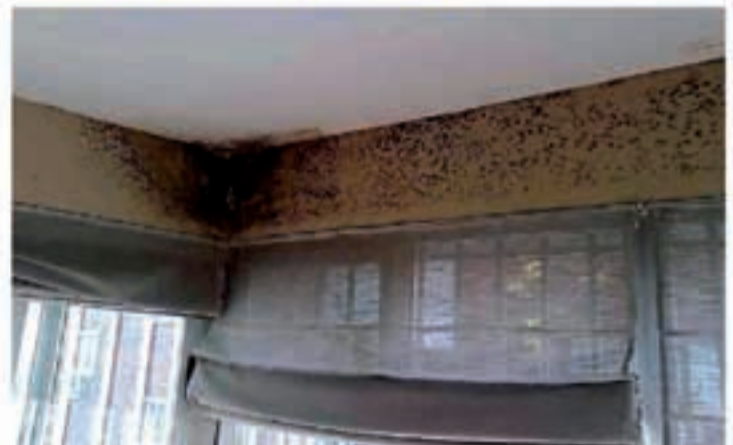
Problemas de humedades por condensación
