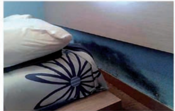
Problemas de humedades por capilaridad
