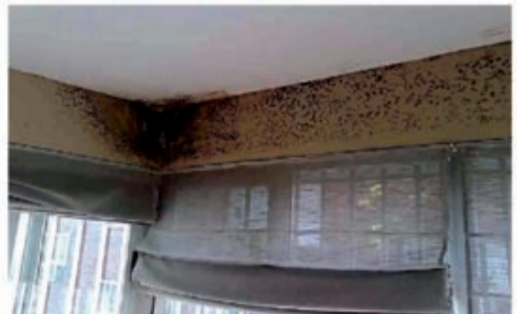
Problemas de humedades por condensación
