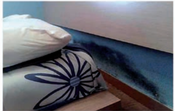
Problemas de humedades por capilaridad
