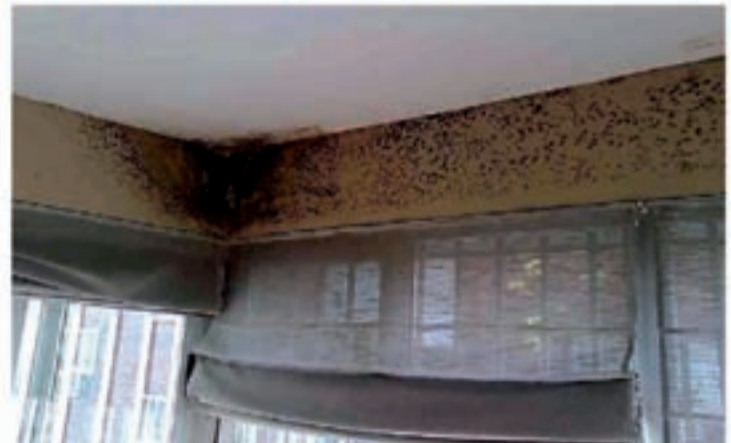
Problemas de humedades por condensación
