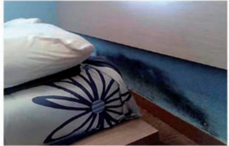
Problemas de humedades por capilaridad
