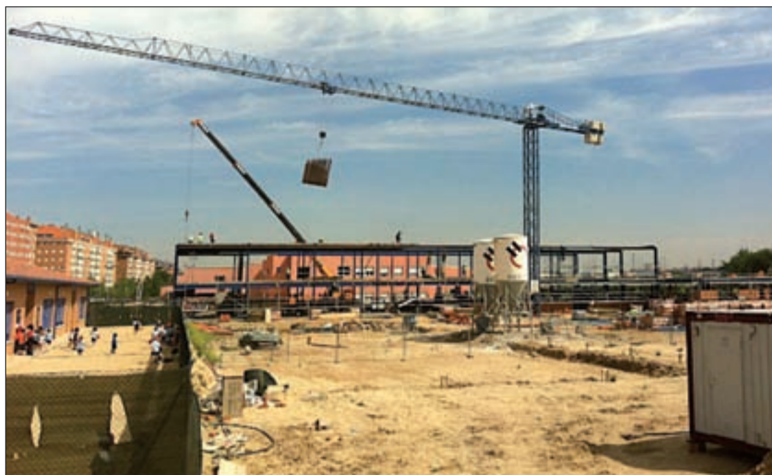
Estado actual de las obras de construcción del colegio Ausias March, en el barrio de Nuevo Rosales
