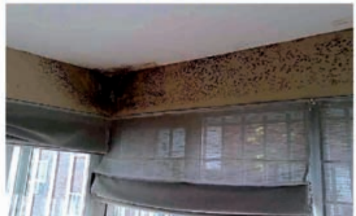
Problemas de humedades por condensación
