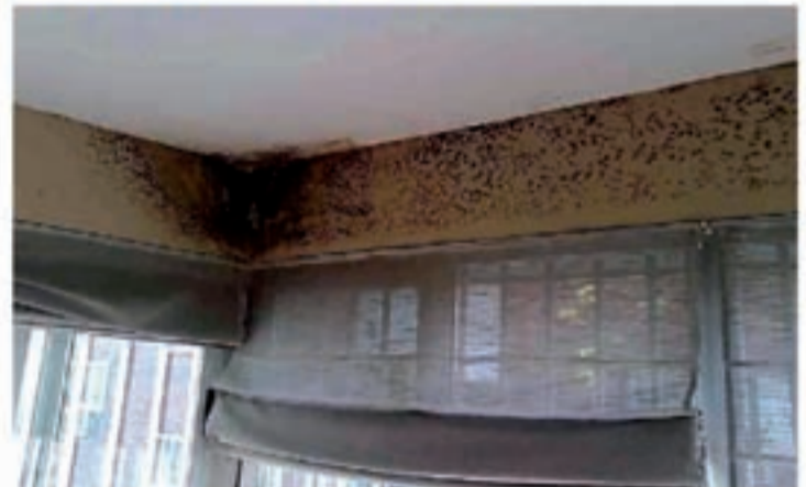
Problemas de humedades por condensación
