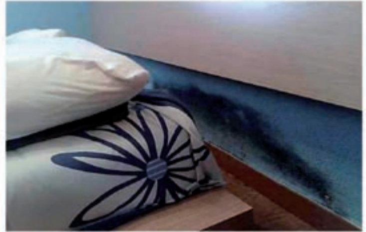
Problemas de humedades por capilaridad
