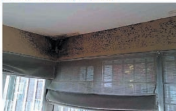
Problemas de humedades por condensación
