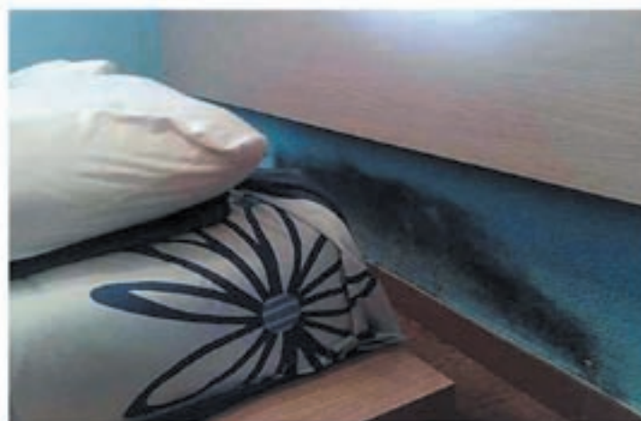
Problemas de humedades por capilaridad
