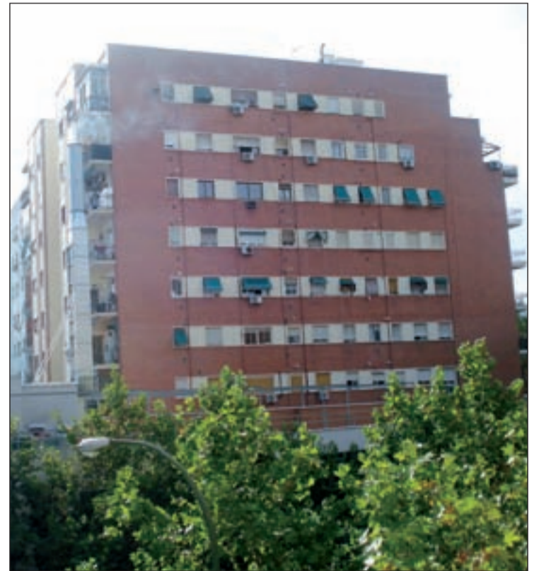
El edificio afectado con la salida de humos del take away portugués
