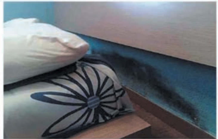
Problemas de humedades por capilaridad
