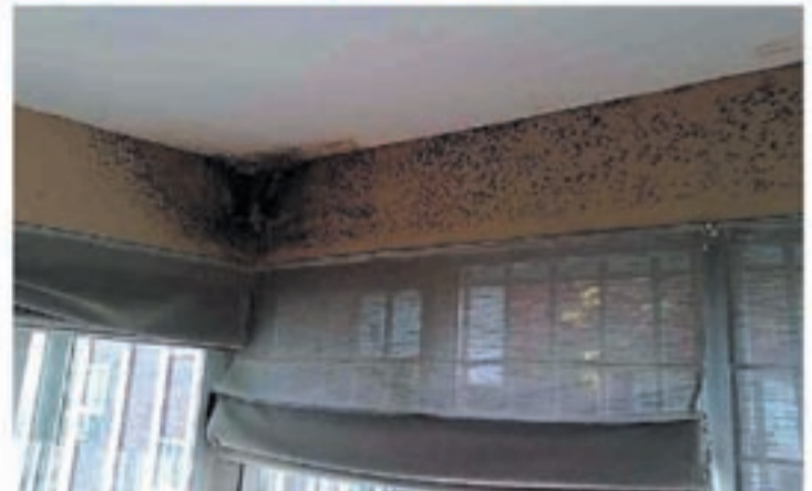
Problemas de humedades por condensación
