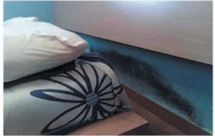
Problemas de humedades por capilaridad
