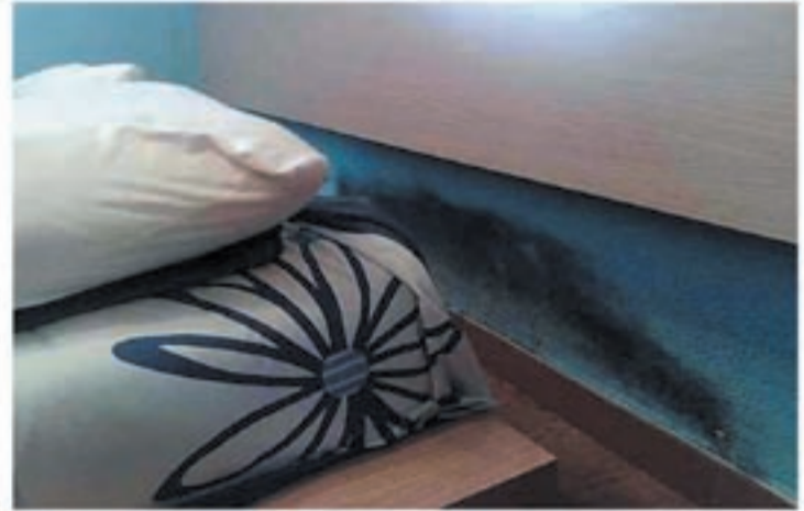
Problemas de humedades por capilaridad
