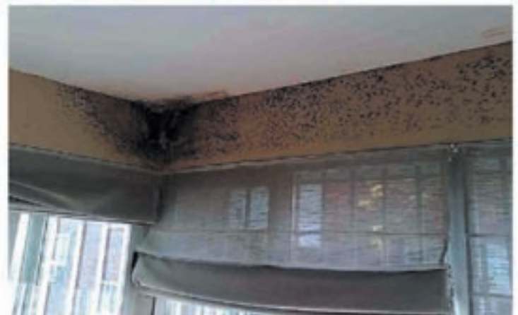
Problemas de humedades por condensación
