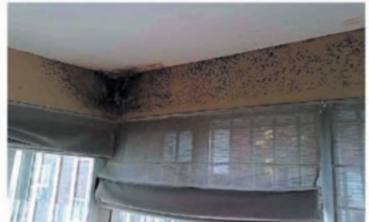
Problemas de humedades por condensación
