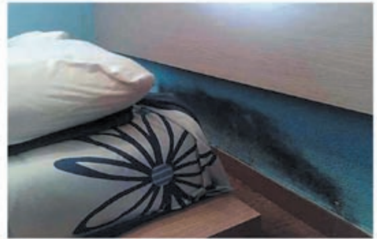
Problemas de humedades por capilaridad
