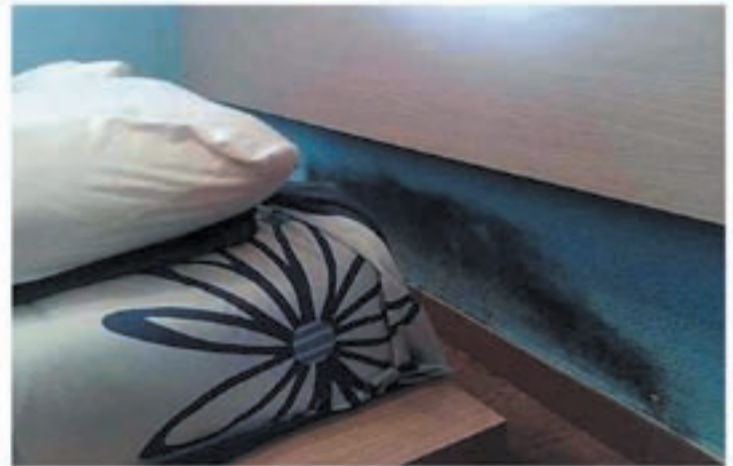
Problemas de humedades por capilaridad
