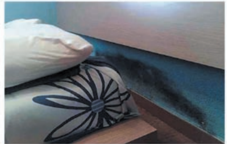
Problemas de humedades por capilaridad
