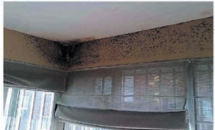
Problemas de humedades por condensación
