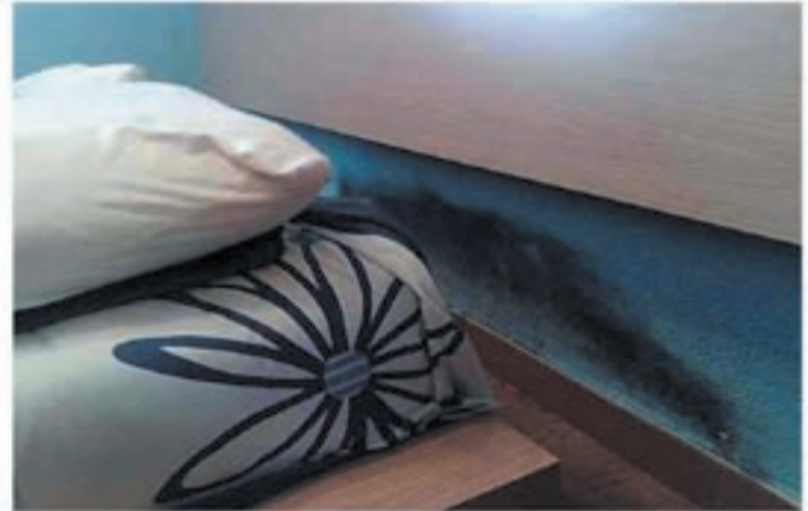
Problemas de humedades por capilaridad
